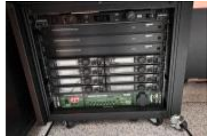
울진문화예술회관 음향시설 사진
